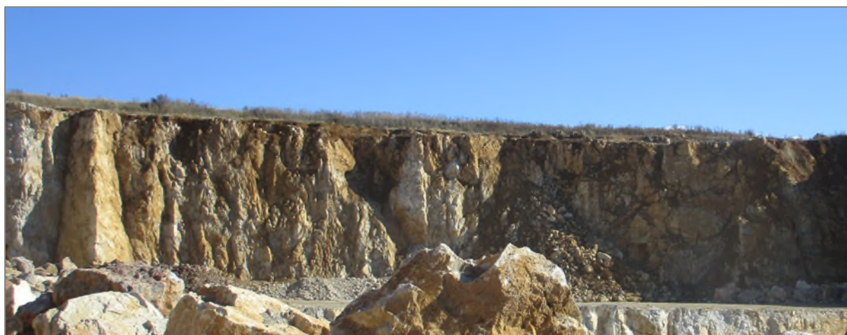
Figure 216 : Exemple d'un gradin supérieur présentant des zones altérées (ARIES, 2018)
