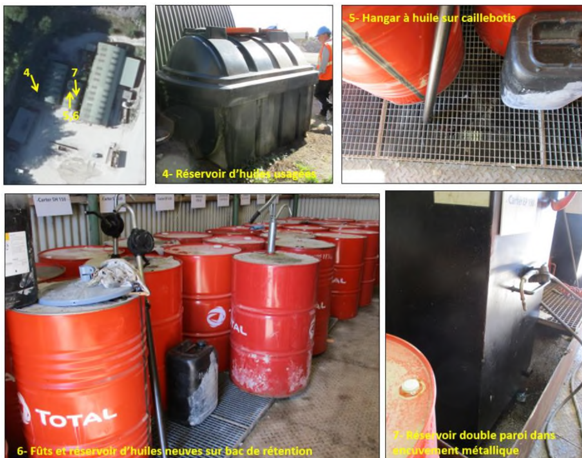
Figure 223 : Atelier à l'ouest du bassin-tampon d'eaux claires : Local à huiles neuves sur caillebotis et encuvements et réservoir d'huiles usagées à l'extérieur de ce local (WalOnMap et ARIES, 2019)
