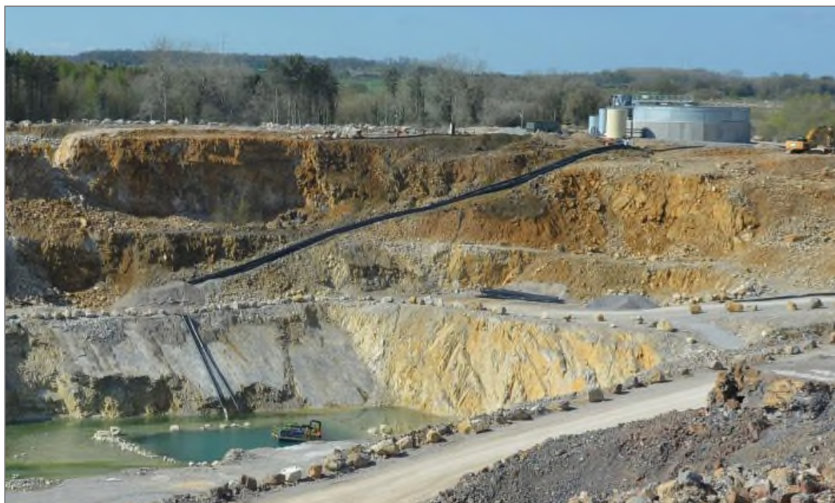
Figure 243 : Nouveau clarificateur mis en service fin 2023 (ARIES, 2023)
