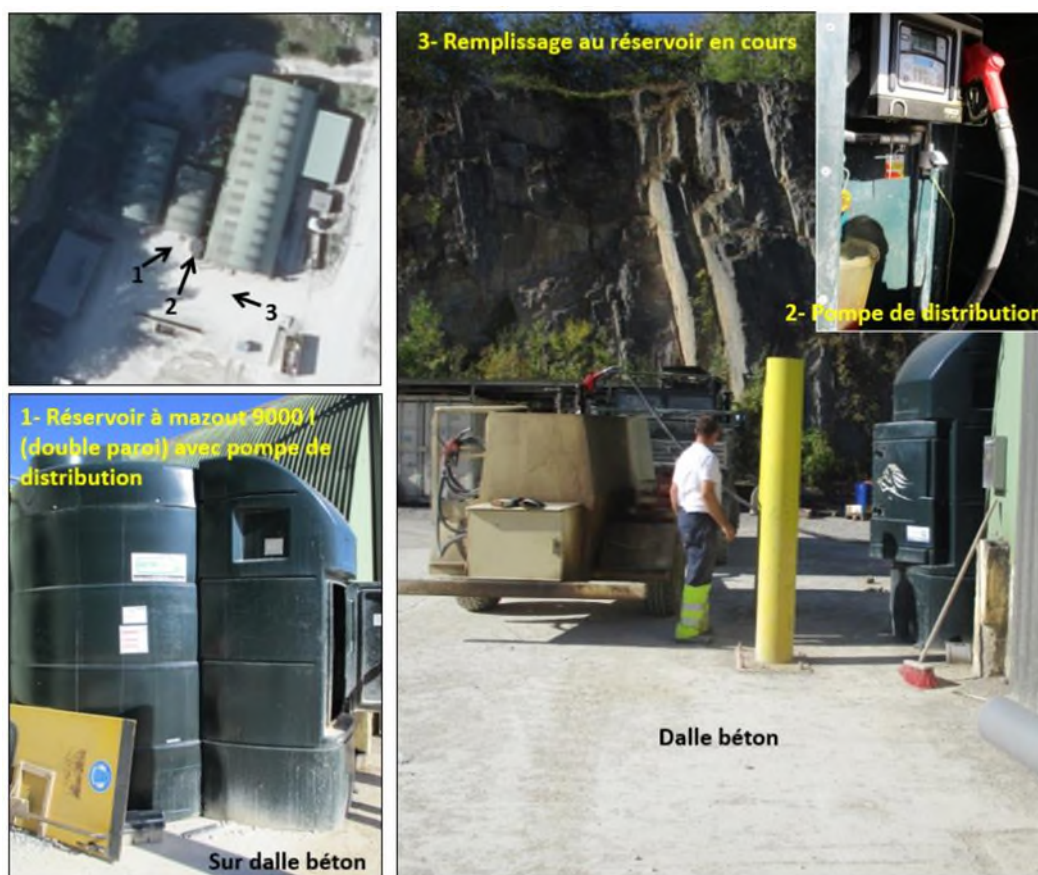
Figure 222 : Atelier à l'ouest du bassin-tampon d'eaux claires : réservoir à mazout (9.000 l) avec pompe de distribution (WalOnMap et ARIES, 2019)
